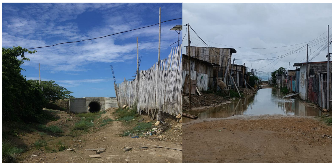
Ilustración 46 Alcantarilla en el paso lateral y agua acumulada por las lluvias.
